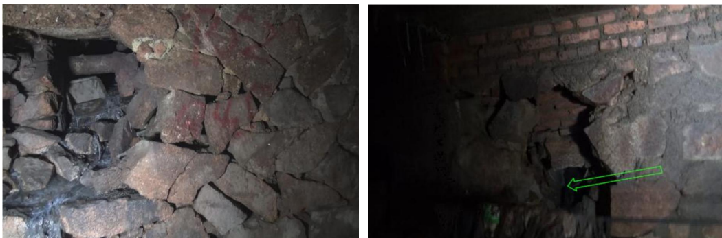
京南路暗涵结构性安全隐患——侧墙垮塌
