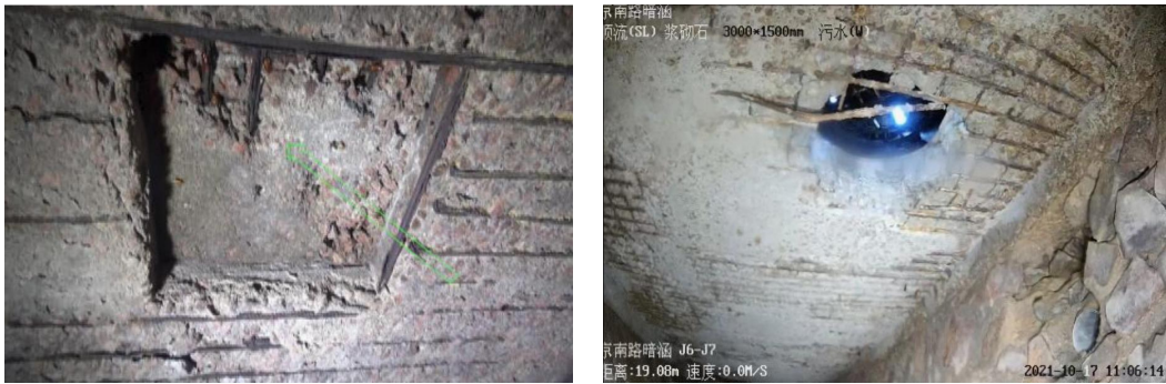
京南路现状暗涵结构性安全隐患——腐蚀露筋
