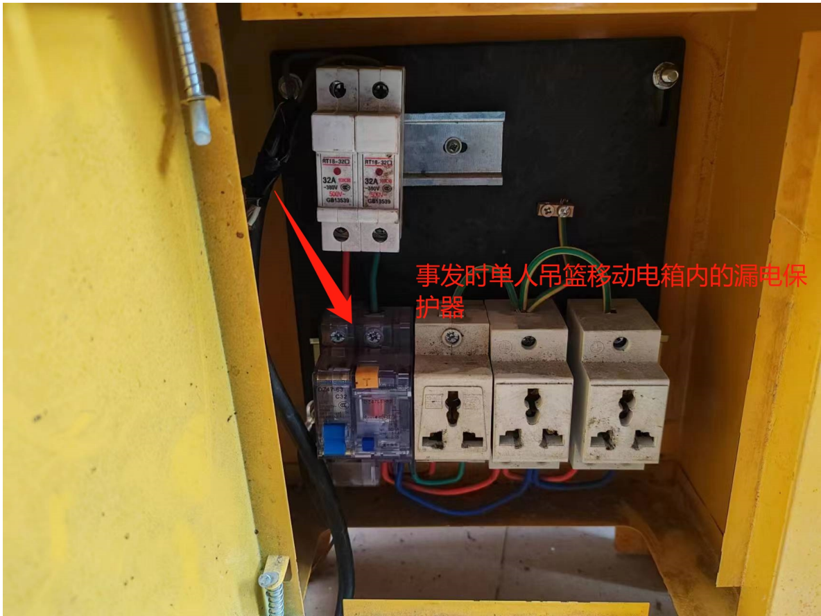
单人吊篮供电线路的移动电源控制箱
