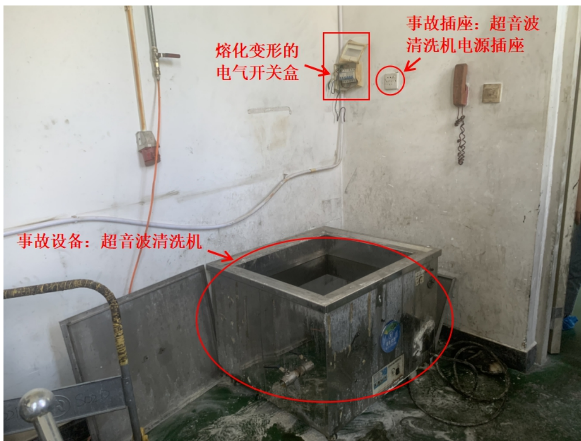
图 3 发生事故后超声波清洗机及周边情况
