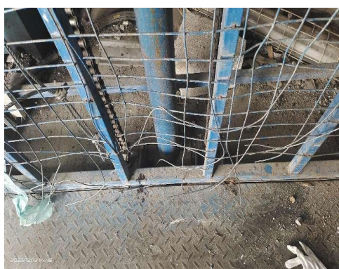
图 4 防护网底部左侧钢筋脱落
