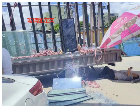
图 2：事故现场照片
