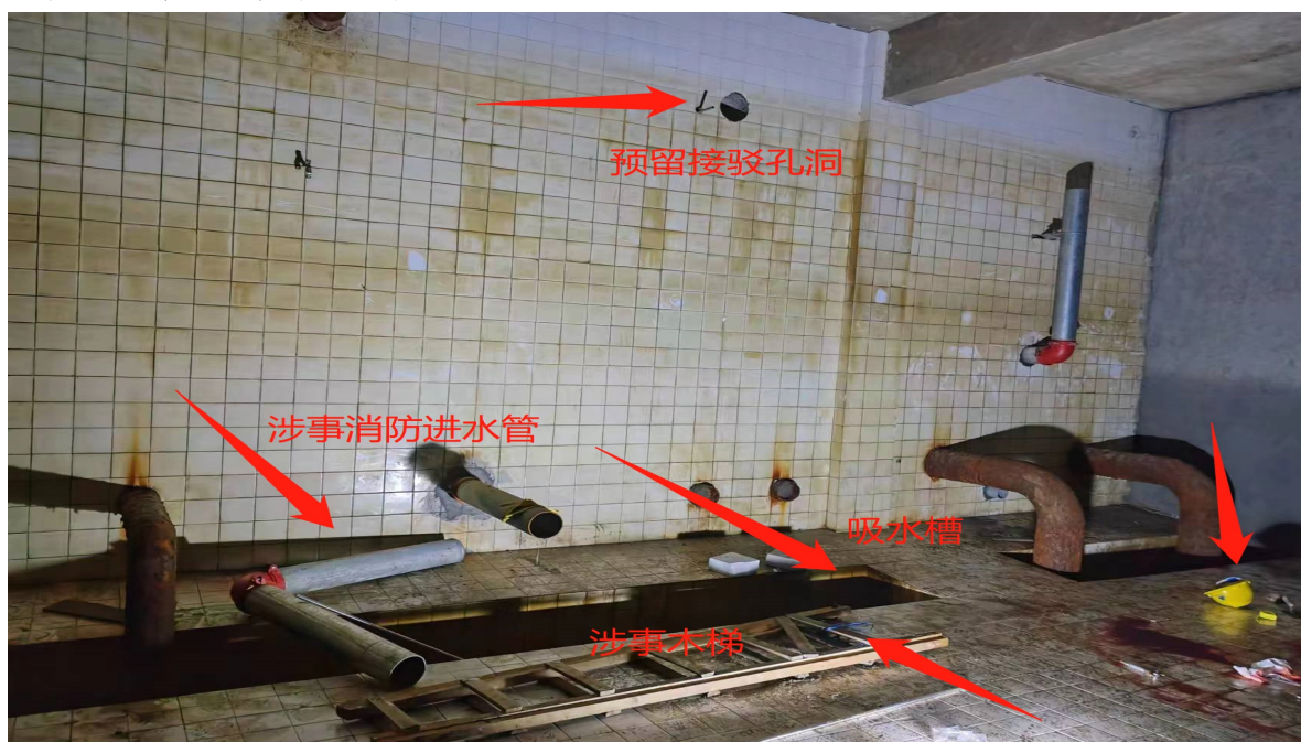
事故现场照片
