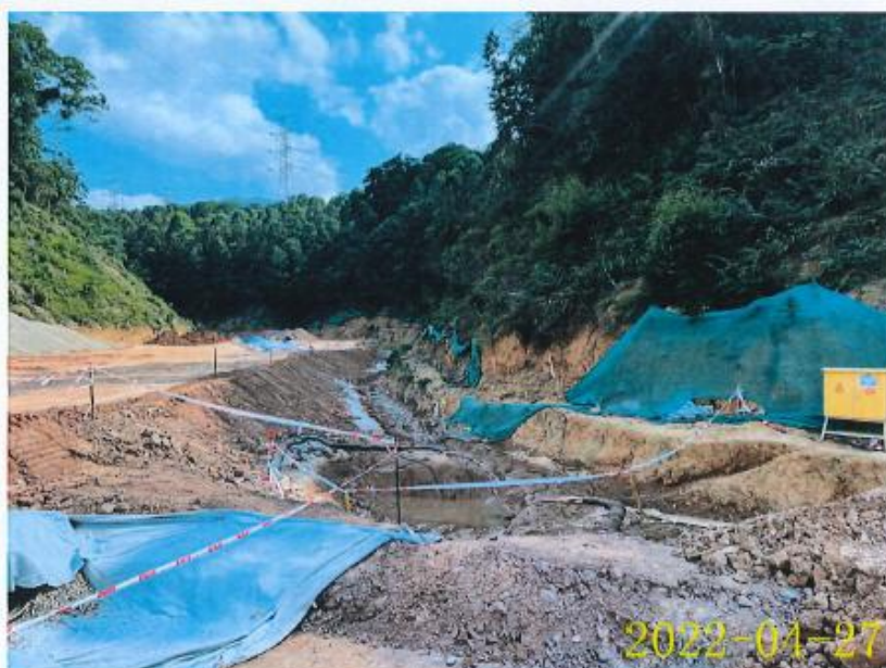
图 2. 项目山体渗水仍采用简易土沟排导，未做防渗处理，易浸泡填土。
