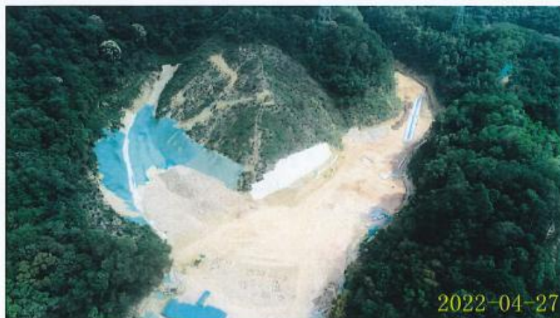
图 1. 项目区已建截排水、沉沙等措施较水土保持方案设计工程量偏少。
