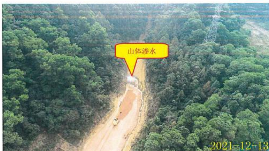
图 2. 项目未布设盲沟、竖井等措施，山体渗水仅采用简易土沟排导，未做防渗处理，易浸泡填土，存在安全隐患。
