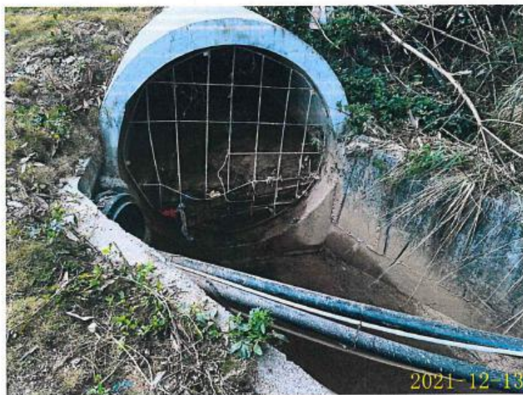
图 4. 项目排水管涵泥沙淤积较严重，未及时清理。
