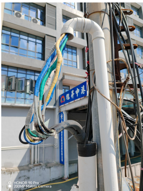
图 4 破损强电线路
