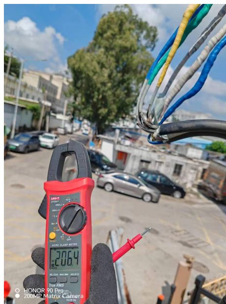
图 5 破损强电线路测试电压
