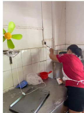
龙城街道龙西东路 42 号（浙江包子店），（二）16、燃气报警器未通电
