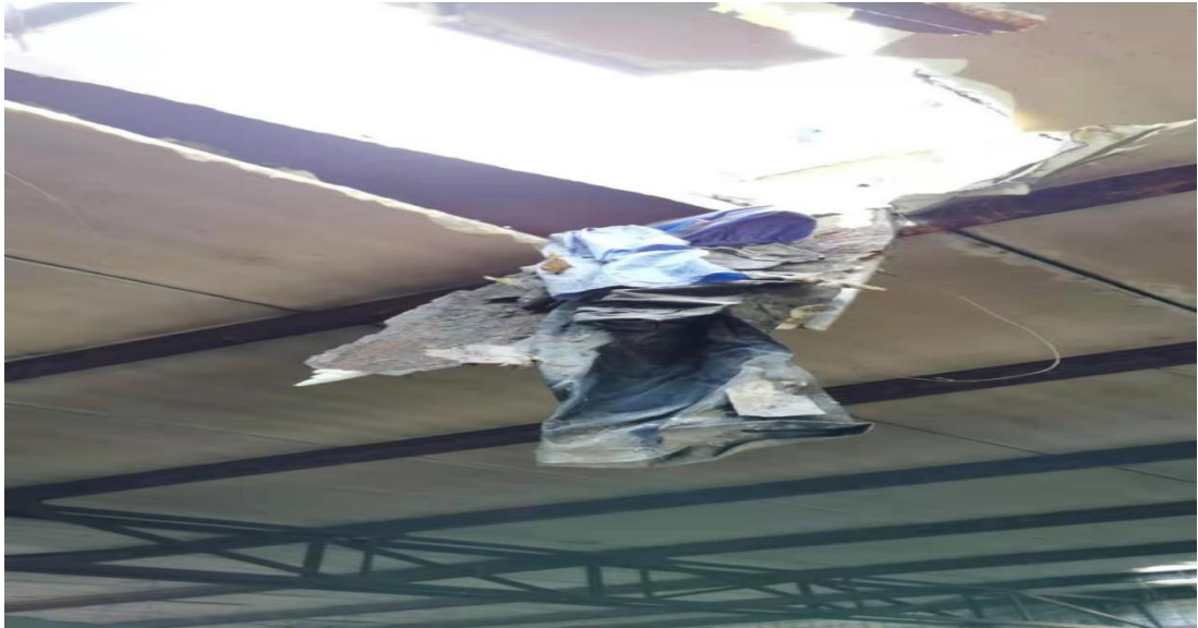
图 2 铁皮房棚顶破裂的洞口
