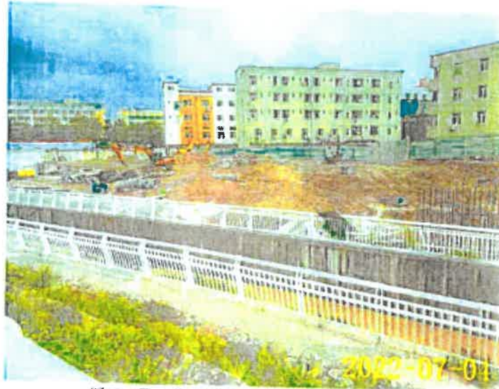
图2. 项目临河施工区域防护措施不足。
