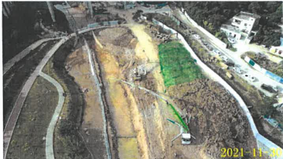
图 2. 项目跨黄竹坑水施工区地表及堆土裸露，土体松散，防护措施严重不足。
