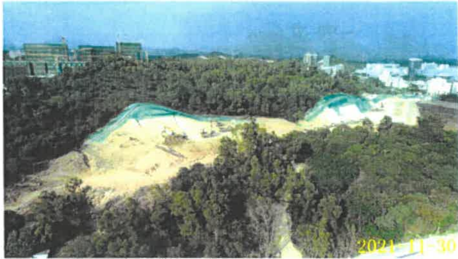
图 1. 项目开挖边坡高陡，裸露面积大，防护措施不足，存在水土流失隐患。
